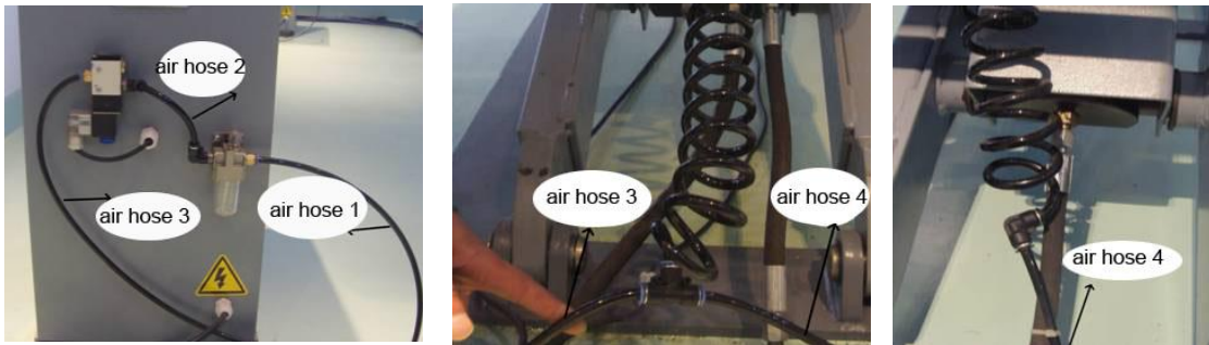
Bilder, som viser tilkobling av luftslanger (air hose)
